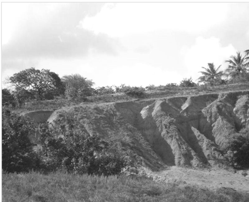
Figura 2: Vista geral do talude de corte com um processo avançado de erosão – voçorocas.
