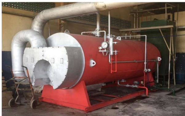
Figura 2: Vista Frontal da Caldeira.
