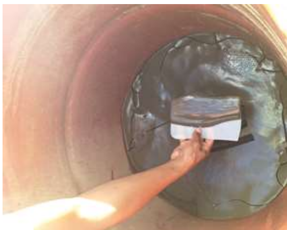
Figura 6: Recolhimento do lodo decantado.
