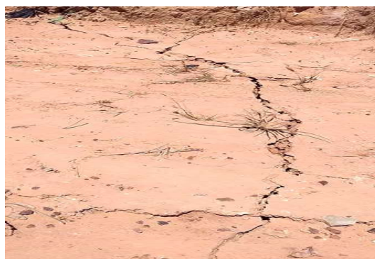
Figura 3: Fissura presente no aterro sanitário de Maceió.
