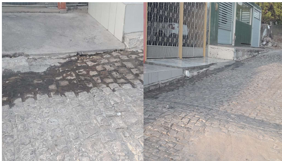
Figura 4: Vazamento de água pelas tubulações no bairro São Judas Tadeu, município de Pau dos Ferros/RN.
