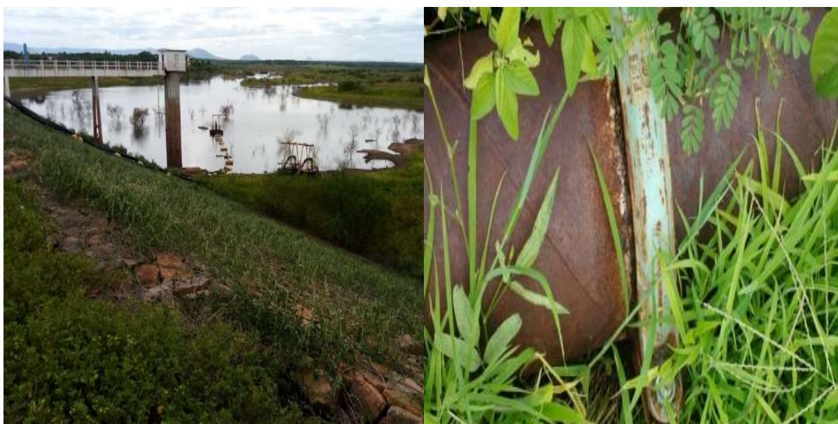
Figura 5: (a) Reservatório de água Dr. Pedro Diógenes em volume morto antes do período de chuva na cidade Pau dos Ferros/RN. (b) Estado de conservação de parte da tubulação da adutora, localizada no início da cidade de Pau dos Ferros/RN, Bairro João XXIII. Fonte: Oliveira (2018).
