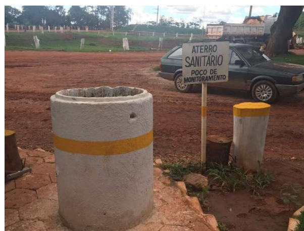
Figura 6: Poço de monitoramento.
