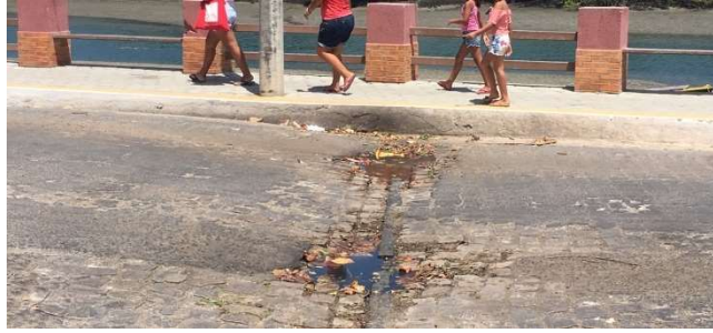
Figura 12: Esgoto a céu aberto na região central de Guimarães/RN.
