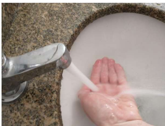
Figura 7: Vazão em excesso em lavatório.
