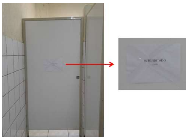
Figura 5: Interdição de banheiro por vazamento de água, em maio de 2019.
