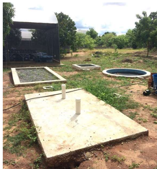
Figura 8: Vista da área experimental onde se encontra o sistema ecológico de tratamento de água residuária sanitária.
