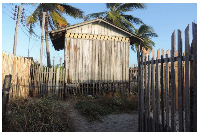
Figura 5: Casa do gerador de energia elétrica da comunidade.
