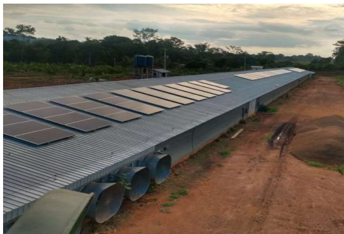
Figura 5: Sistema de energia solar em aviário na Granja Dalva em Cacoal-RO.
