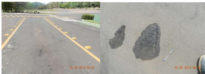
Figura 4: Desagregação no pavimento executado
