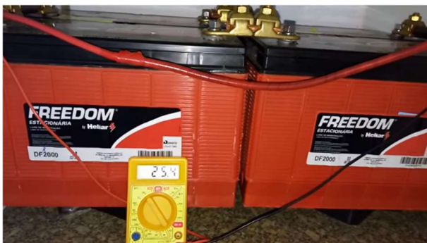
Figura 5: Ligação em série das baterias e medidas exatas de suas devidas tensões somadas.
