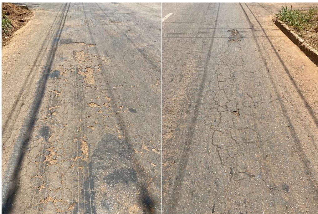
Figura 4: Trincas interligadas tipo couro de jacaré com erosão na TO-050 em Porto Nacional - TO.
