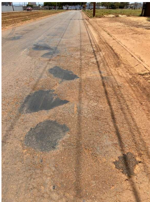
Figura 5: Presença de trincas tipo couro de jacaré e remendo.
