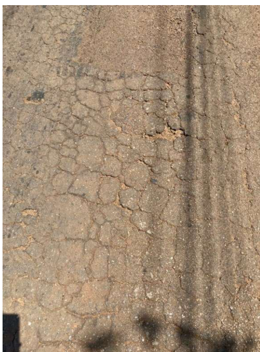
Figura 3: Trinca tipo couro de jacaré observada na TO-050 em Porto Nacional - TO.
