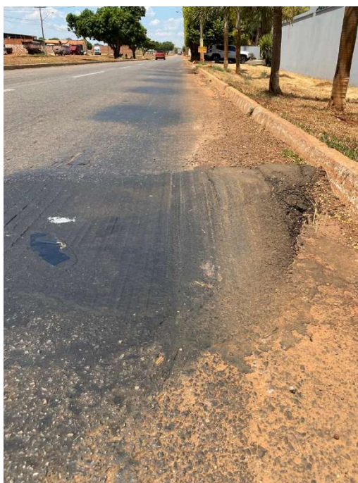
Figura 9: Exsudação e escorregamento na rodovia TO-050 em Porto Nacional - TO.
