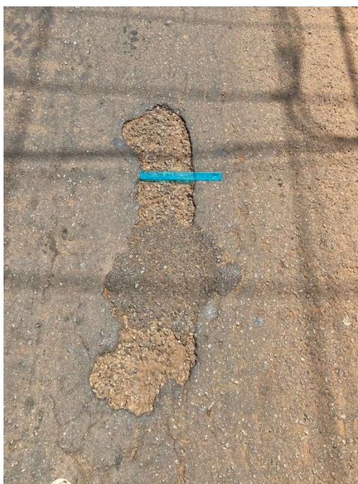
Figura 7: Painela com remendo ao meio na rodovia TO-050 em Porto Nacional - TO.
