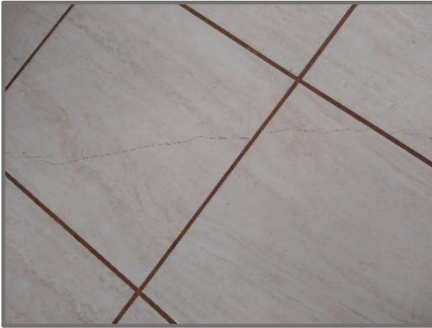
Figura 6: Fissuras no revestimento cerâmico.
