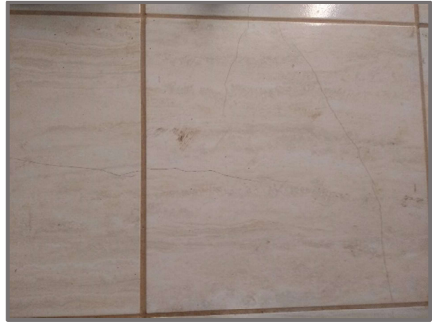
Figura 7: Fissuras no revestimento cerâmico.
