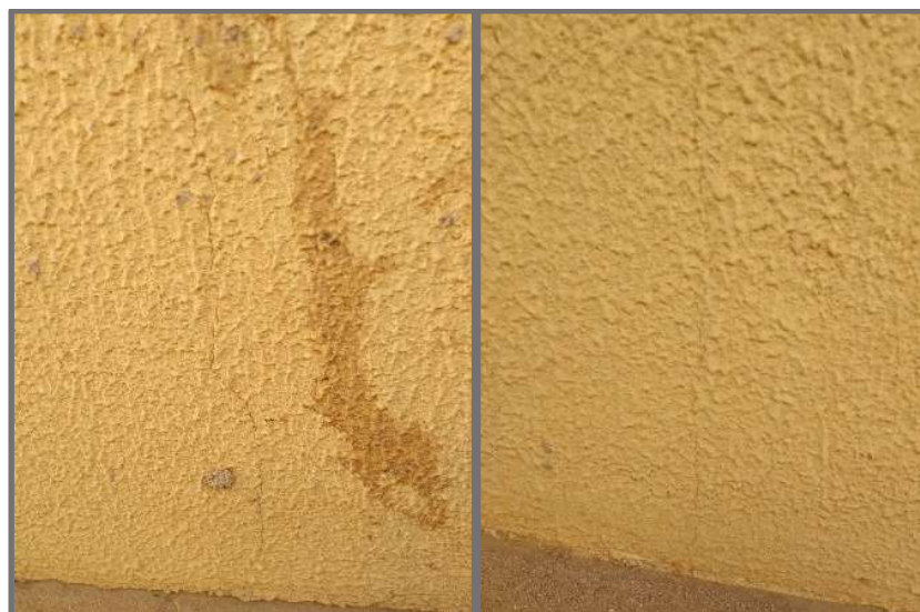
Figura 5: Fissuras na parede.
