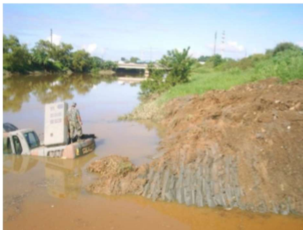
Figura 3: Acidente envolvendo escavação de solo mole. Fonte: Carvalhais (2017).
