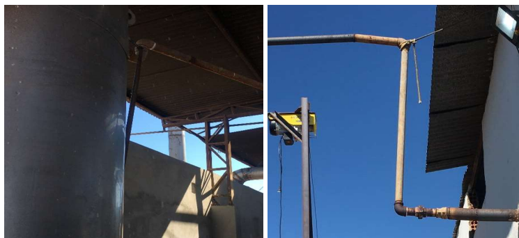
Figura 4: Saída tubulação da caldeira.
