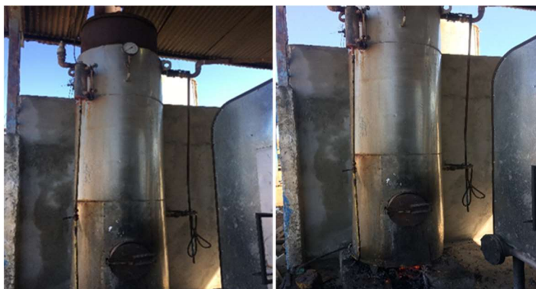
Figura 1: Identificação da caldeira flamo tubular vertical.
