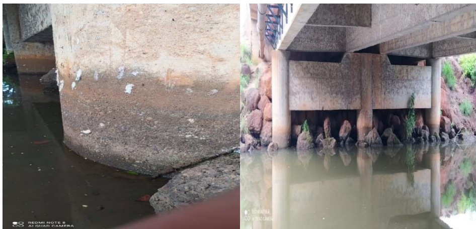
Figuras 5 e 6: Lixiviação na base do pilar.
