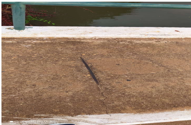
Figura 6: Desagregação e corrosão na estrutura.
