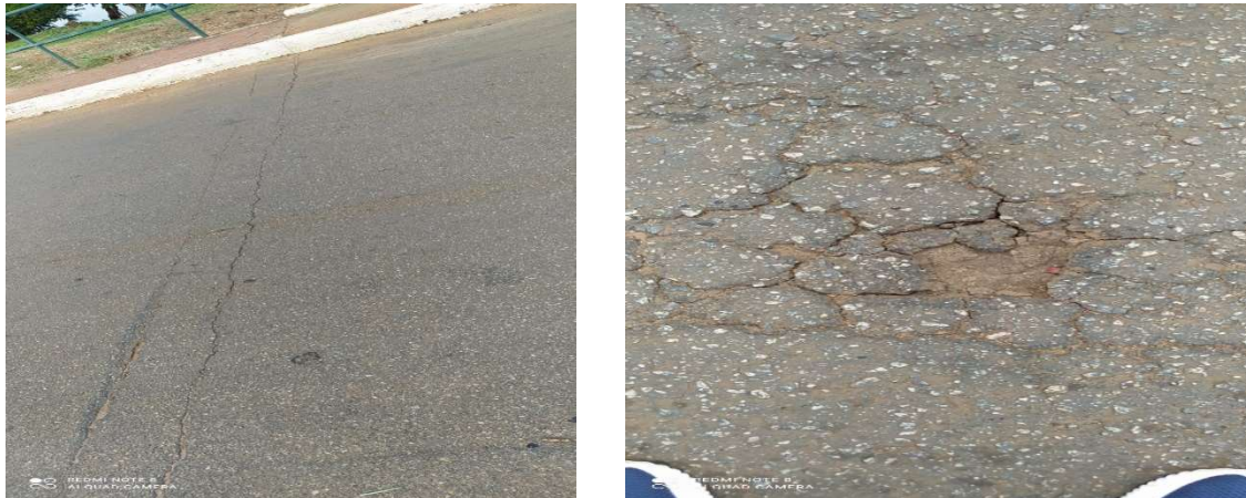
Figuras 3 e 4: Fissuras e trincas no tabuleiro.
