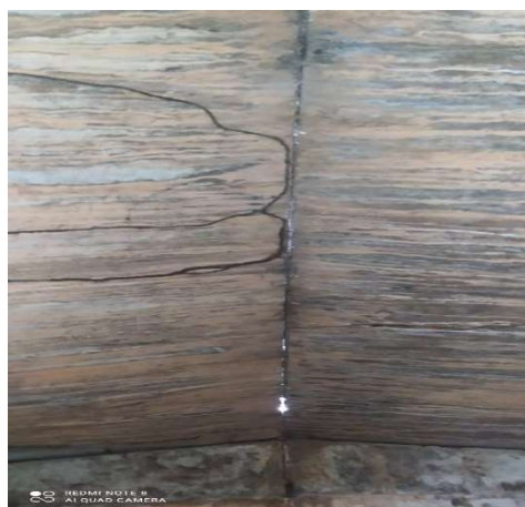
Figura 7: Reação Álcali Agregado na estrutura.
