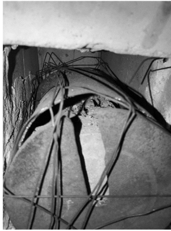
Figura 6: Corpo de prova de concreto após spalling dentro do encamisamento.
