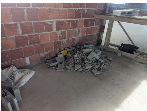
Figura 5: Resíduos amontoados sem sinalização na Obra
