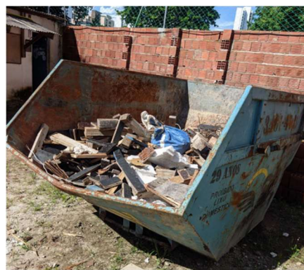
Figura 3: Disposição dos resíduos sem separação (Obra 2).
