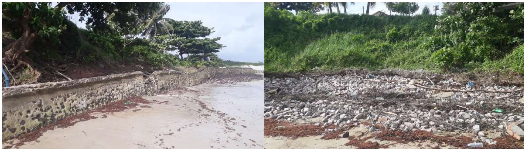
Figura 6: Erosão costeira encontrada na praia do Maçarico.
