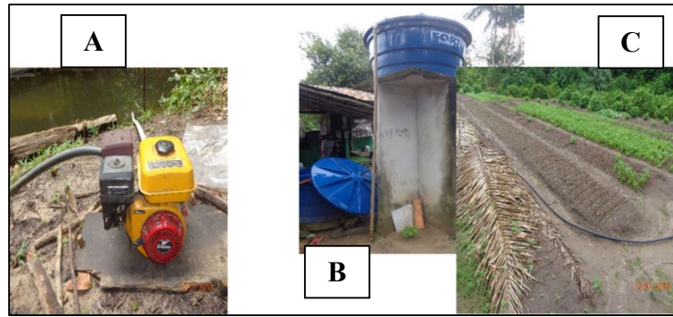
Figura 5: a) motobomba de 40 HP utilizado para captação de água; b) reservatórios da residência; c) encanações para irrigação de horticultura. Sítio Jonas. Nova Timboteua – PA.
